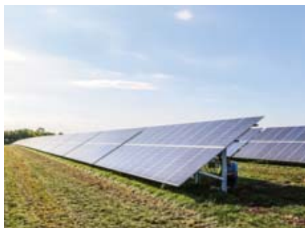
Die Sun Contracting AG zählt mit aktuell 37 Megawattpeak installierter und projektierte Leistung zu den größten Solarenergieunternehmen Europas
