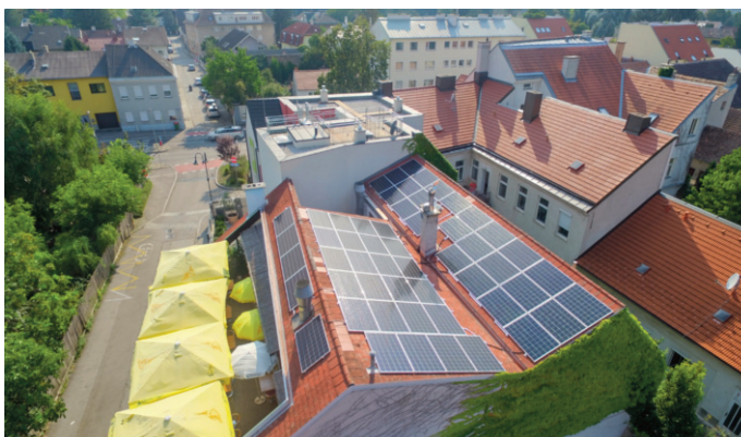
Das unterm Dach befindliche Restaurant in Langenzerdorf (NÖ) hat durch die Küche untertags einen hohen Stromverbrauch. Die mit einer ÖMAG-Förderung installierte PV-Anlage mit 17,2 kWp wird sich in sechs Jahren amortisiert haben
