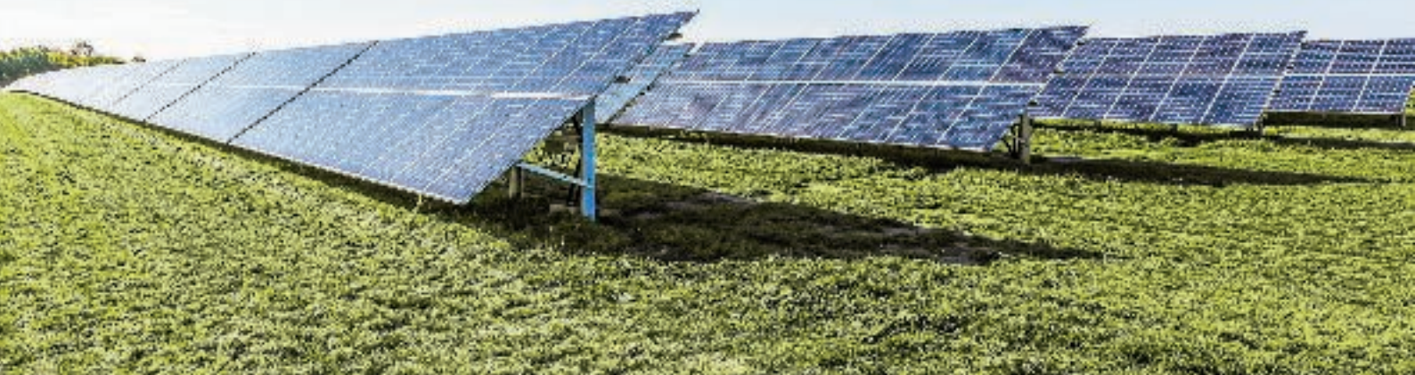
1,5 Megawattpeak Freiflächenanlage in Angern an der March (NÖ), betrieben von einer Tochtergesellschaft von Sun Contracting
